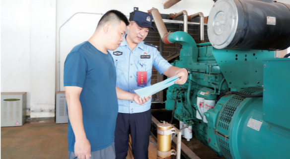
民警王龙(右)检查监狱发电机运行情况。通讯员李莹 摄
