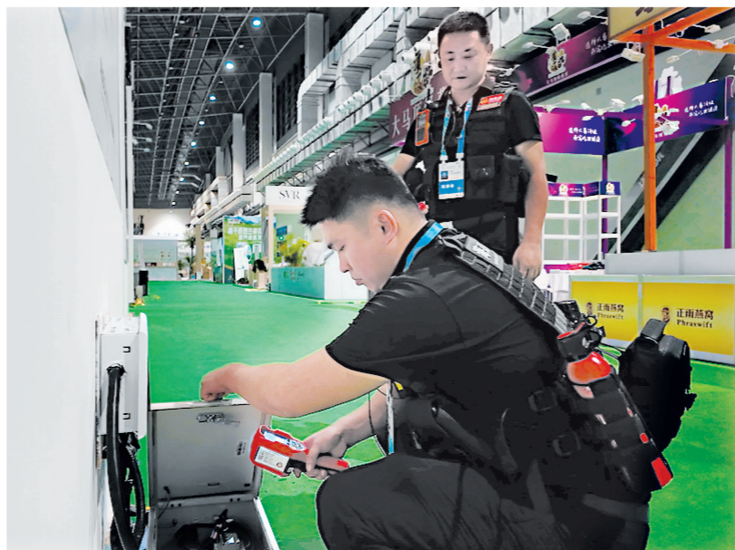
夜间，海口消防员化身“展馆巡夜人”，为每一个用电设备“量体温”，确保安全。
