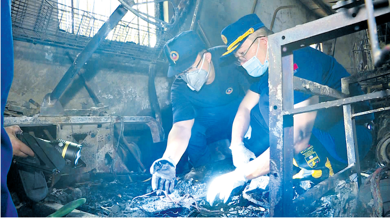
海口消防火调员对现场的电线和连接线路进行逐一排查。记者连蒙 摄
