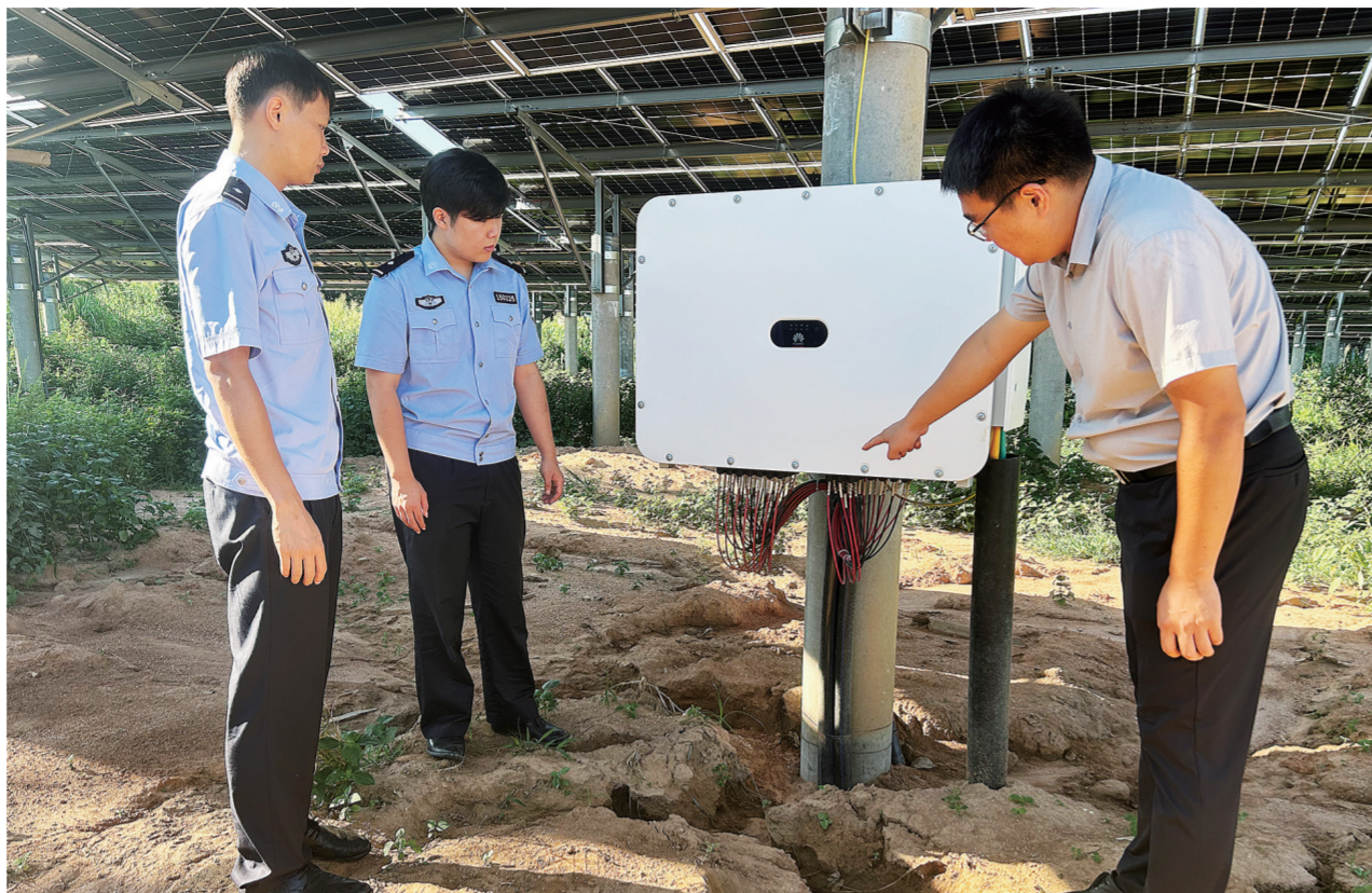
白沙邦溪派出所民警指导项目方做好电缆安全防范工作。记者宋飞杰 摄
