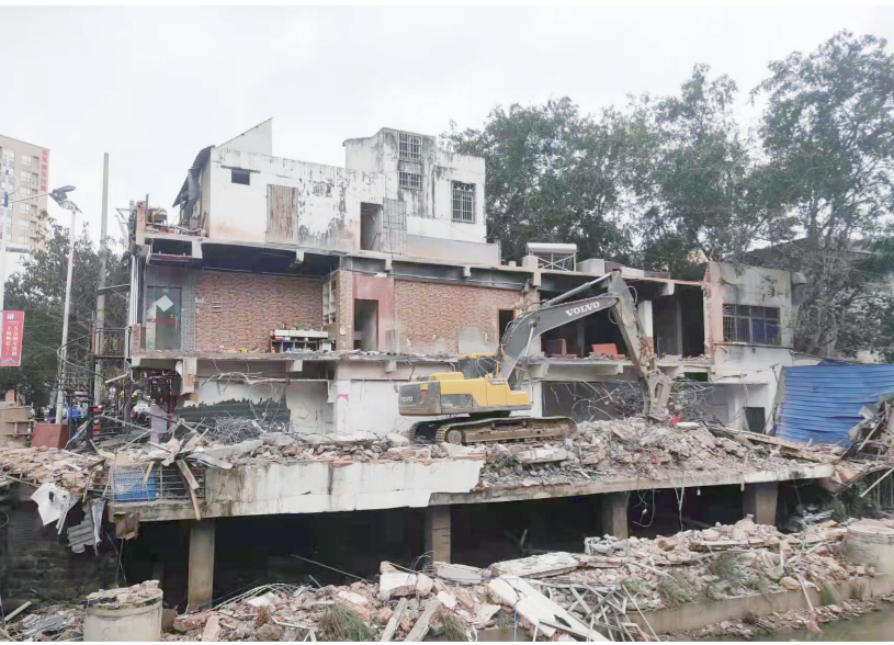
检察官联合澄迈县综合执法局、水务局工作人员前往老城河开展侵占河道违建勘查工作
